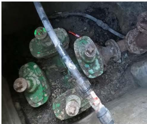
Arqueta A (imagen de lo que se encontró en la esquina del acceso a la calle de los Cotarros, donde se ve que la válvula en cruz quizás conecte con alguna tubería en el cruce de la BI-2701, pero no está claro).
